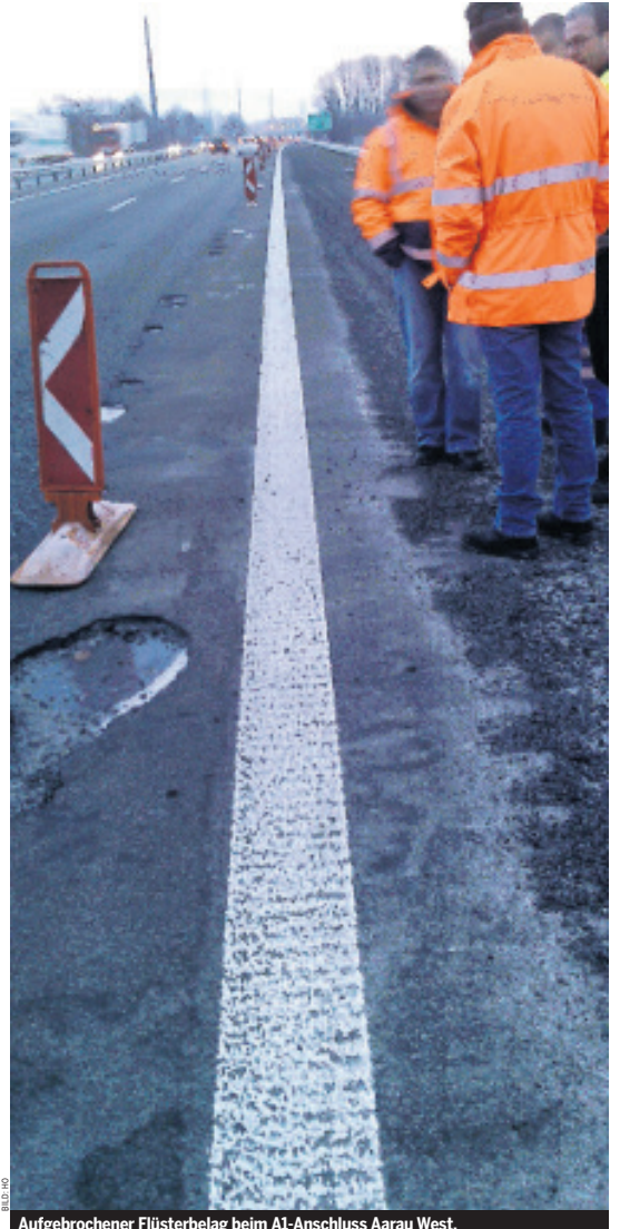
Aufgebrochener Flüsterbelag beim A1-Anschluss Aarau West.
